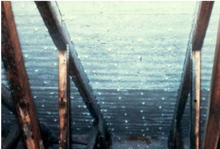
Figure 4 – Givre sous les combles attribuable aux fuites d'air.
