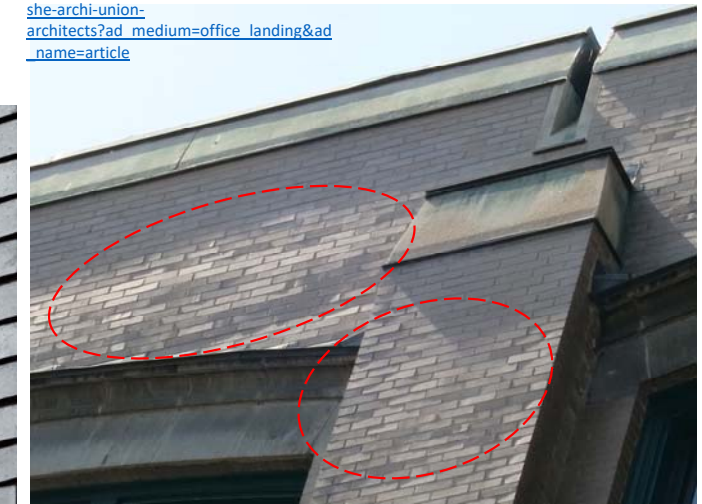
Revêtement du parapet et du sommet des pilastres remplacé au début des années 2000, Édifice fédéral, 715 rue Peel, Montréal, 2015 (L. Godbout).
