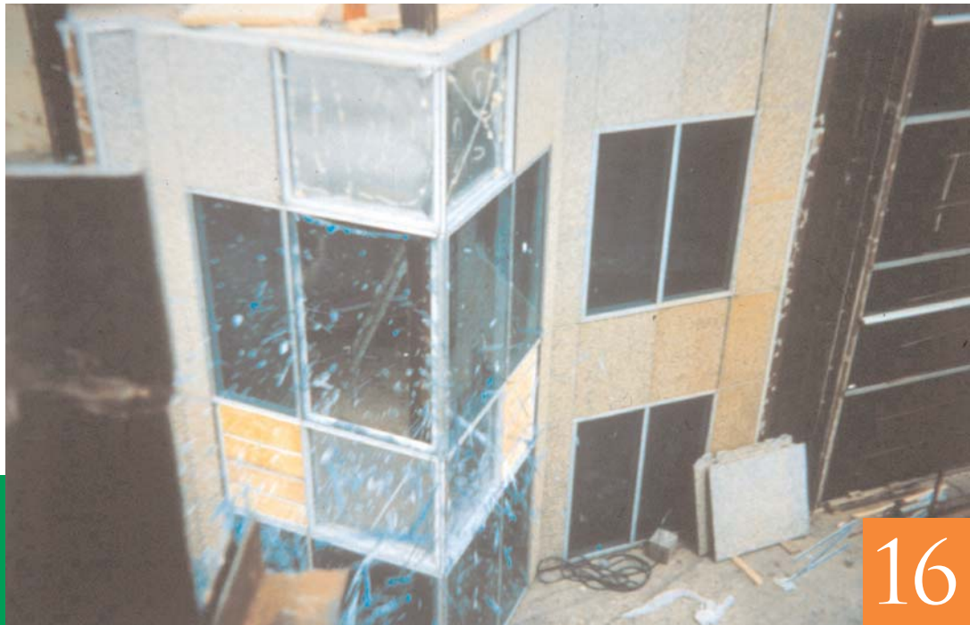
Figure 19 – Défaillance du verre pendant un essai sur un mur-rideau Avec la permission de Morrison Hershfield Ltd.
