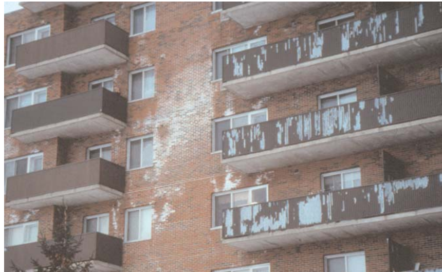
Figure 1 — Les effets des fuites d'eau par les murs
