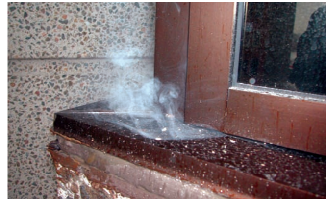
Voici un test d'exfiltration d'air sur une fenêtre, réalisé à l'aide de fumée.
