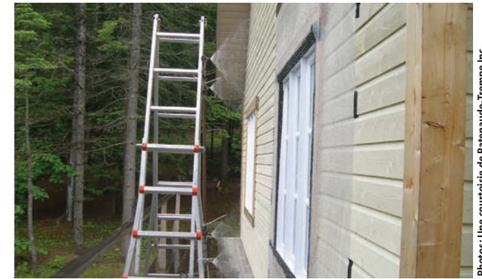
Voici un test d'infiltration d'eau sur une fenêtre, qui simule certaines conditions d'intempéries.
